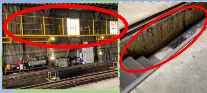
上下から車体を点検できるように施された工夫
